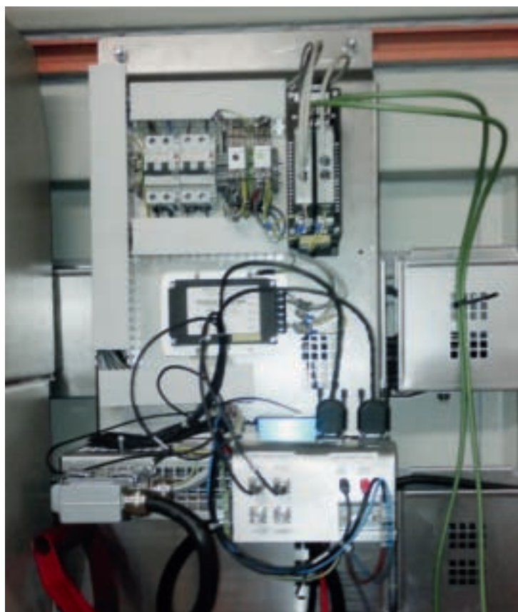
Der Testaufbau, eingebaut im Maschinenraum der Lok.
